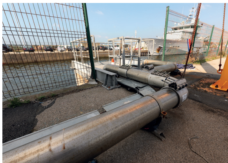
Canalisation de pompage d'eau de mer pour le système de thalassothermie
